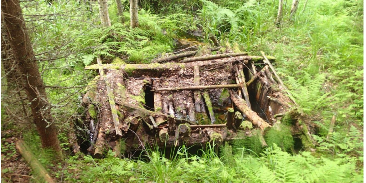
Kuva 29. Innanlahden puron varressa on lähde, jonka päälle on rakennettu katettu kehikko. Rakenteet ovat lahoamassa (kuva: Jari Kärkkäinen 27.7.2017).
