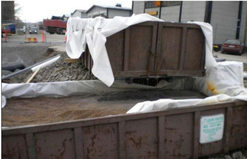
Kuva 16. Vaihtolavalla toteutettu hulevesien suodatus.
